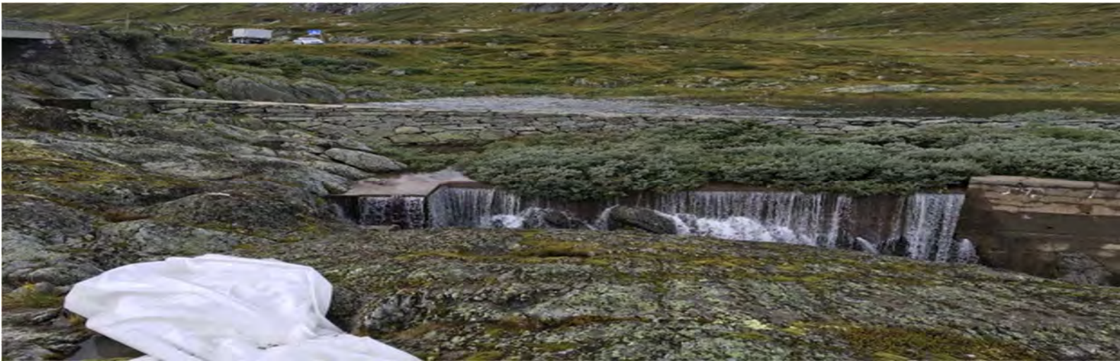
Lekkasje gjennom tørrmur, Bygdin. Foto: Rune Haug/GLB.
