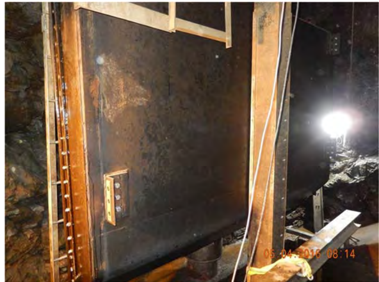
Tappeluka på Bygdin før rehabilitering. Foto: Fredrik Staff Edin/GLB.
