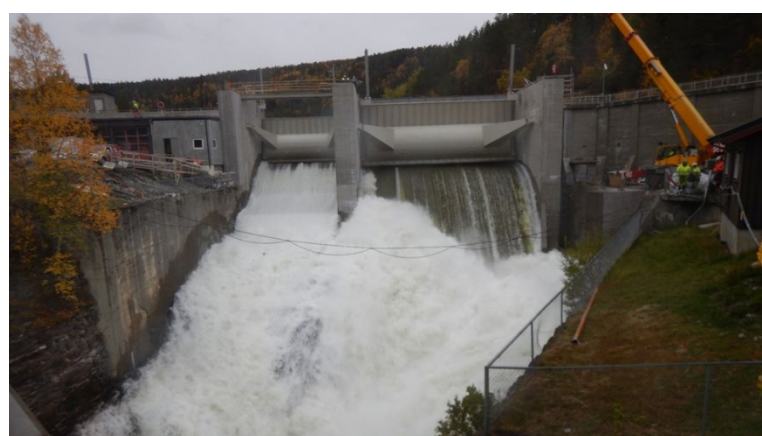
Dam Olstappen – Test av luker, hydraulikkaggregat, telematikk og fjernstyring 27. september. Foto: Steinar Sørлие/Eidsiva
