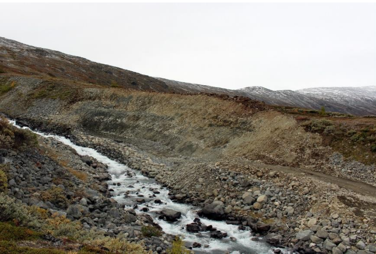
Utslaking av skråning og ny fotsikring skal redusere erosjon og massetransport i Svartholgrove. Foto: Tore Sollibråten/Eidsiva.
