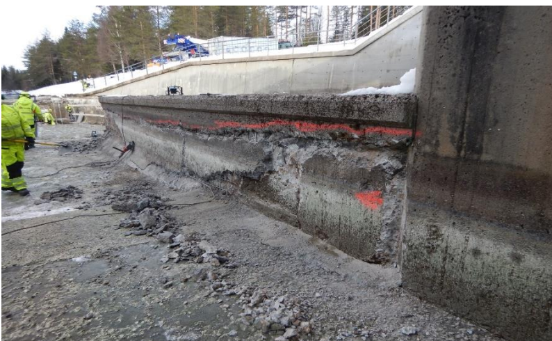
Betongskade i ledemur. Foto: Steinar Sørli/Hafslund Eco.
