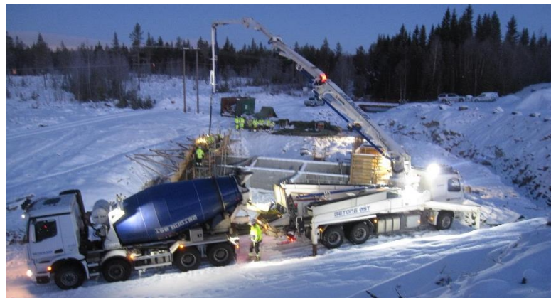
Betongarbeider på dam desember 2021. Omløpskanal til venstre på bildet. Begge foto: Kurt Magne Falling/Hafslund Eco.
