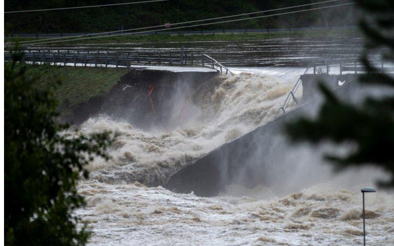
Dambrudd ved Braskereidfoss kraftverk 9. august 2023. Foto: Cornelis Poppe/NTB.
