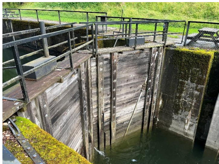
Svanfoss sluser. Foto: Camilla Dorthea Volnes/Hafslund Eco Vannkraft AS.
